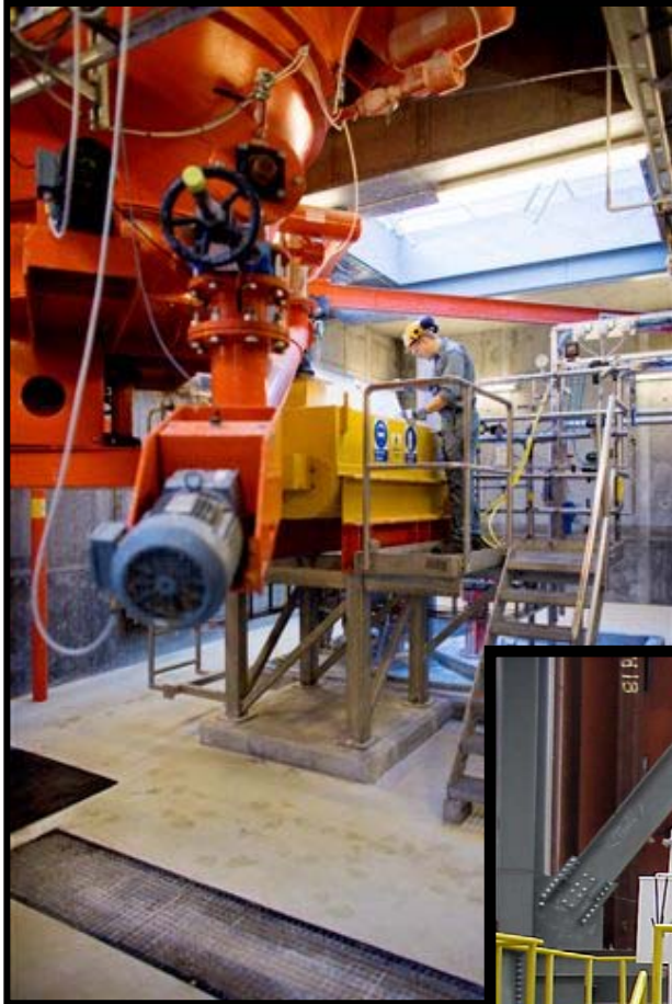
Lime Silo Bottom & Paste Slaker
